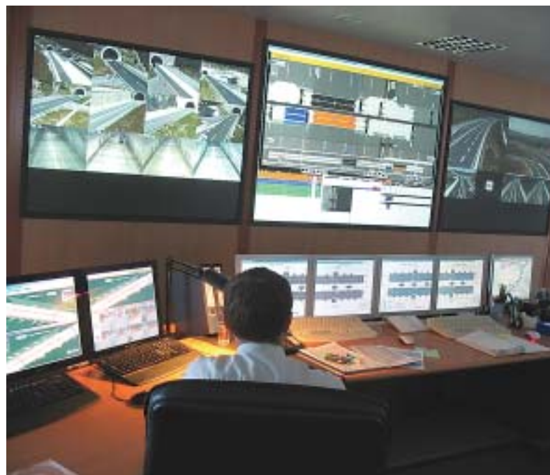
Utrinek s strokovne ekskurzije: Nadzorni center vodenja prometa v Kozini.
